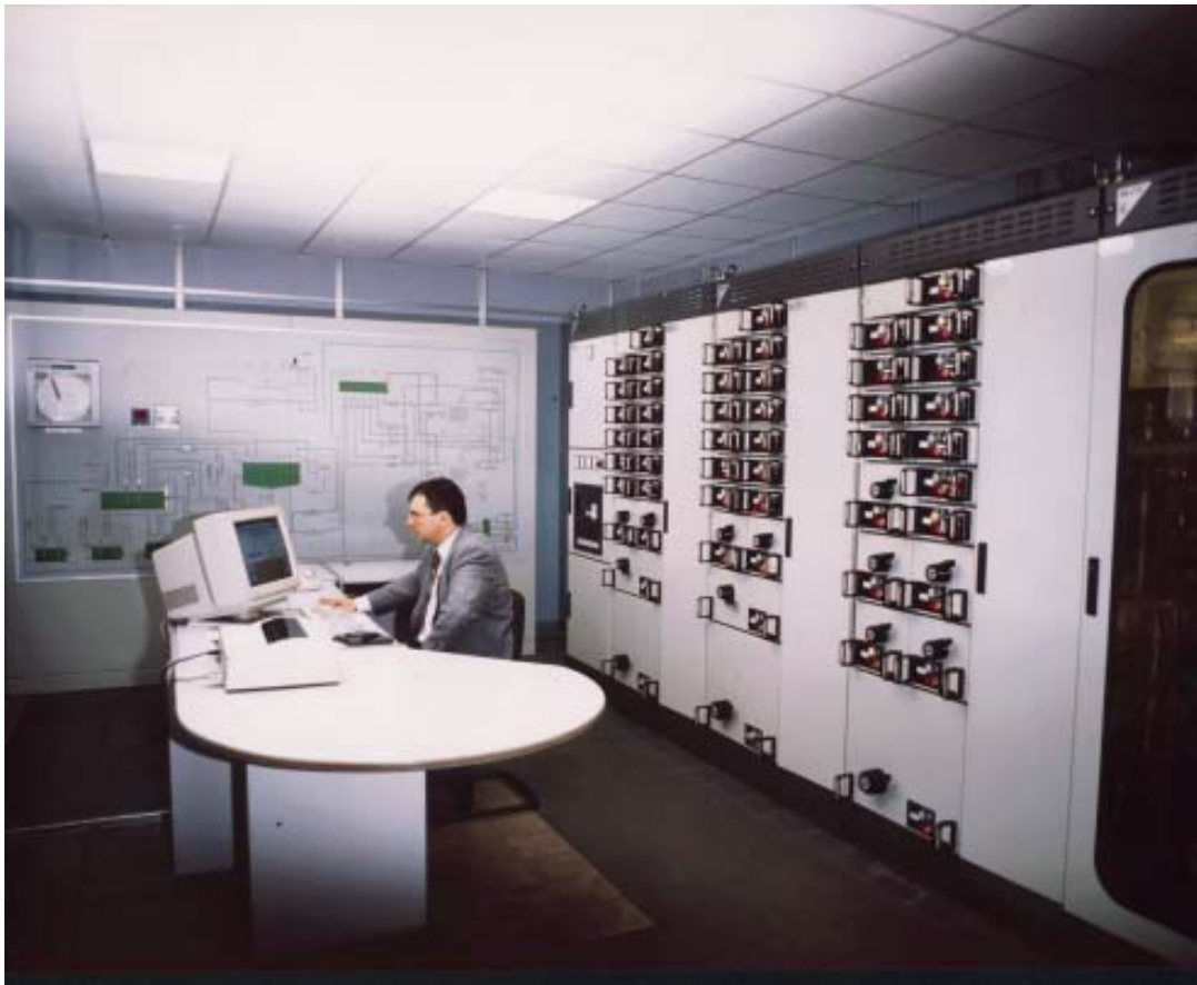
Figura 2 - Sala de Control de Batán
